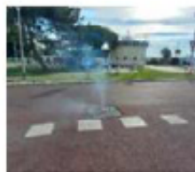
La fumée insufflée dans le réseau d'assainissement ressort par les interstices et permet de mettre en évidence les points critiques. S.O.
