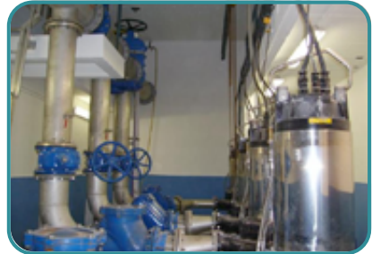
Postes de refoulement du « Rhâ » à Saint-Palais-sur-Mer.
